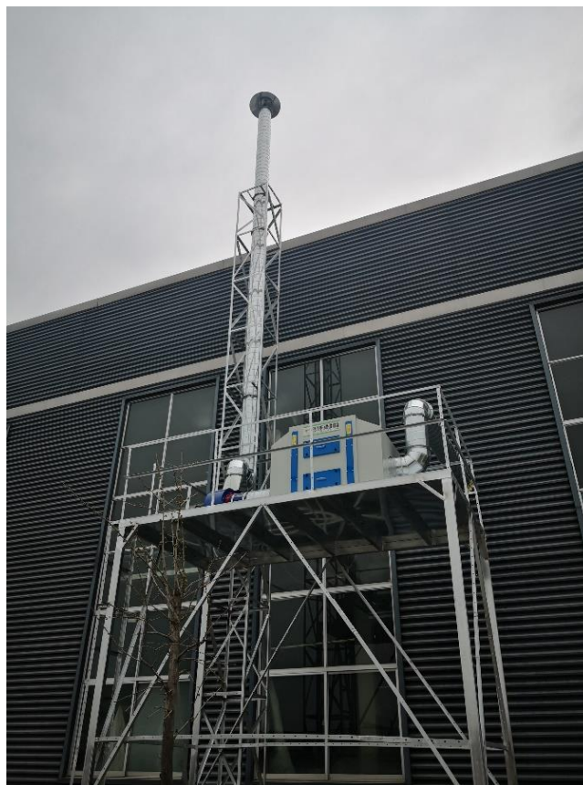
项目活性炭吸附装置及排气筒
